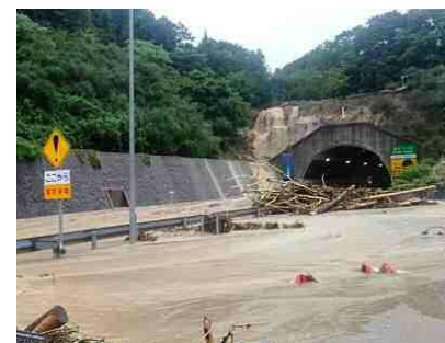
平成30年7月豪雨の被災状況
