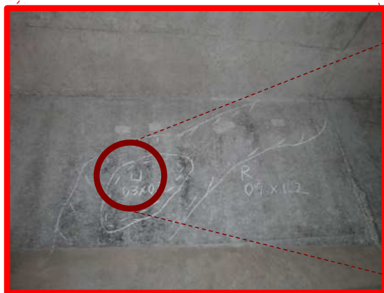
■ シース沿いの遊離石灰
