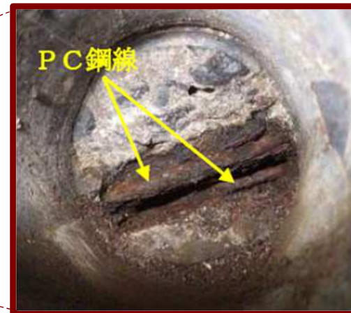
■ PC鋼線の腐食 (コア採取)
