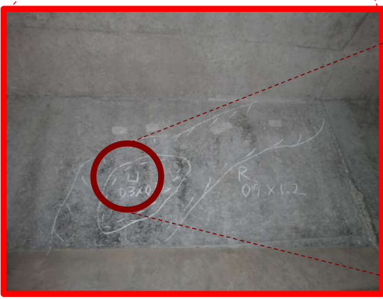
■ シース沿いの遊離石灰
